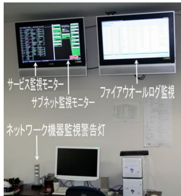
図 4-2 ネットワーク監視装置
