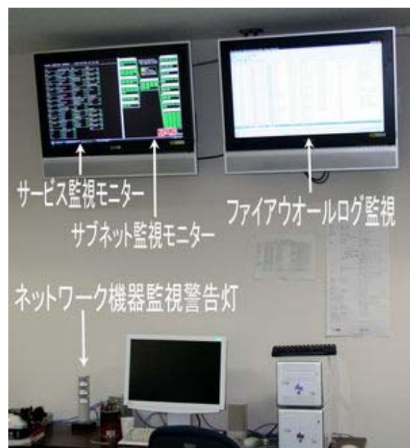
図 4-2 ネットワーク監視装置
